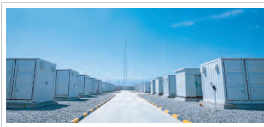
新疆吉木萨尔150MWh光储项目 Jimusaer 150MWh Project
