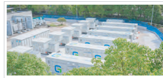
浙江仙鹤新能源有限公司44.72MWh储能项目 Zhejiang Xianhe New Energy Co., LTD. 44.72MWh Energy Storage Project
