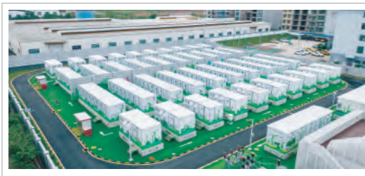
广西南宁100MWh储能电站项目 Nanning 100MWh Energy Storage Project
